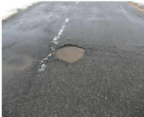
写真-1 ポットホール（冬期間）
