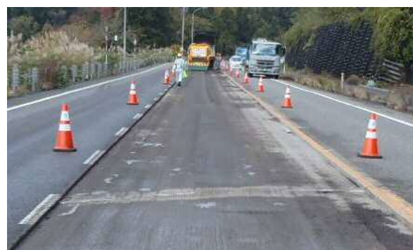
写真-8 リフレクシオンクラック
