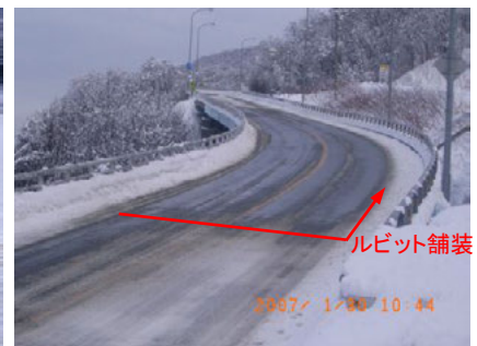
写真-5 14年目路面状況(北海道)
