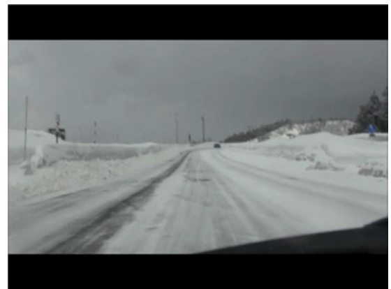
写真-11 一般舗装部の冬期路面状況
