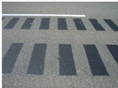
写真-5 1 冬後のシートの状況
