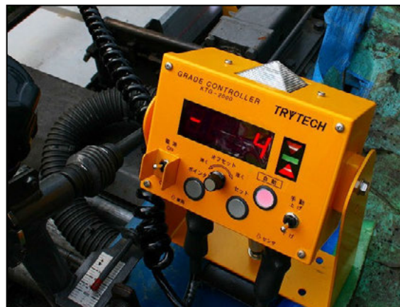
(写真-6 コントロールBOX部)
