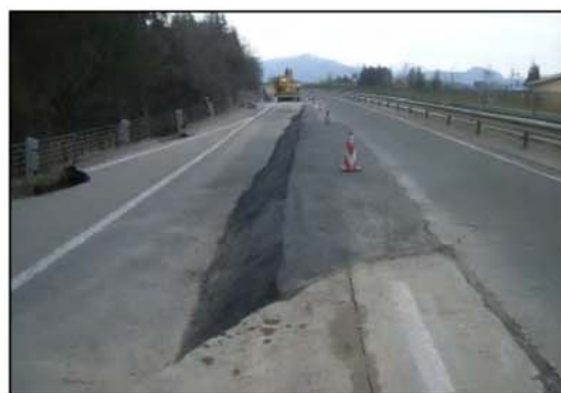
【山形道 陥没処理】
