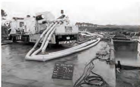
排水機場 仙台東部地区緊急排水業務委託
