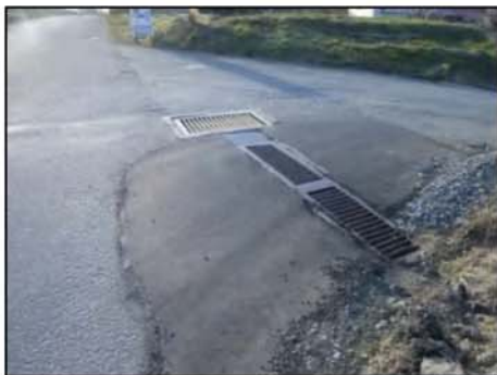
【国道 45 号迂回路(宮城・気仙沼市)】
