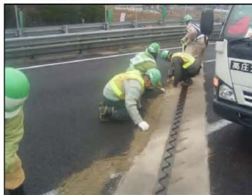
【東北道 橋梁段差】
