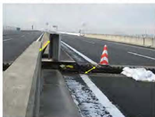
写真-1 橋梁ジョイントの損傷状況 1)
