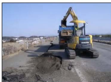
【東北道 陥没処理】
