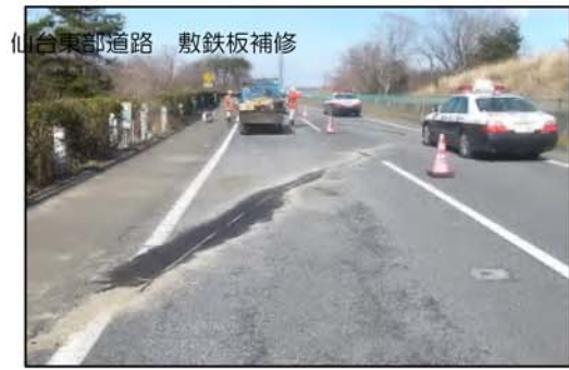
【東北道 段差修正】
